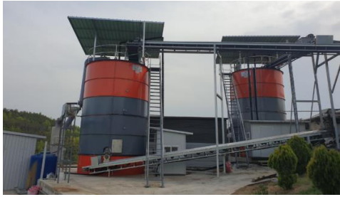
축사 내 설치된 퇴비 건조기
